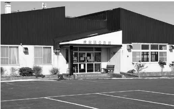
老朽化が進む指定避難所の「虎杖浜公民館」
