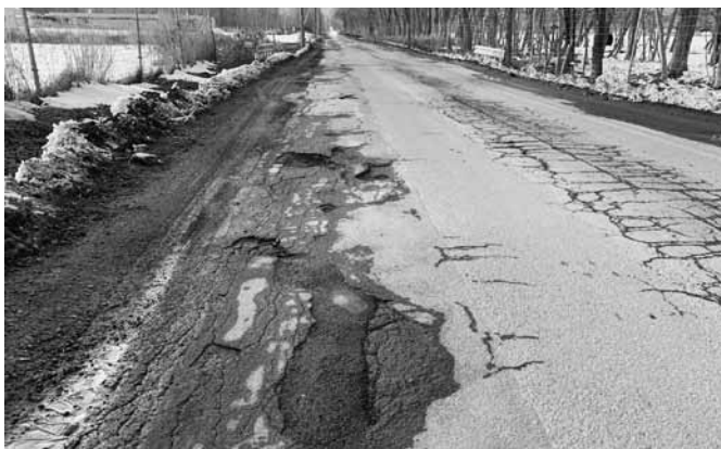
飛生線上に拡大する舗装穴
